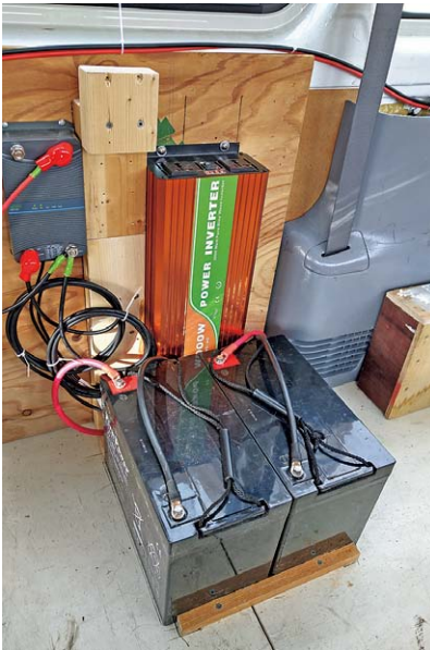
ハイエースにはソーラーパネル、充電コントローラー、サブバッテリー、インバーター、冷蔵庫を装備。
